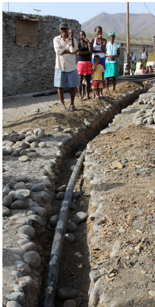
Construction du premier réseau d'eaux pour les communautés de Ribeira Grande de Santiago au Cap-Vert, financée par la Coopération espagnole.
