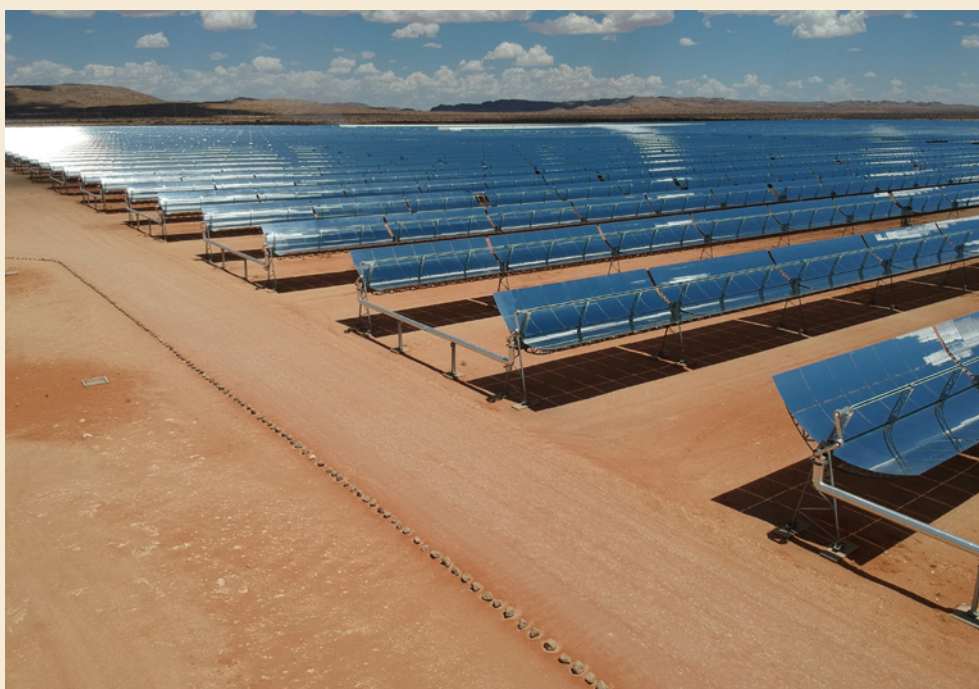
Centrale solaire thermique en Afrique du Sud.
